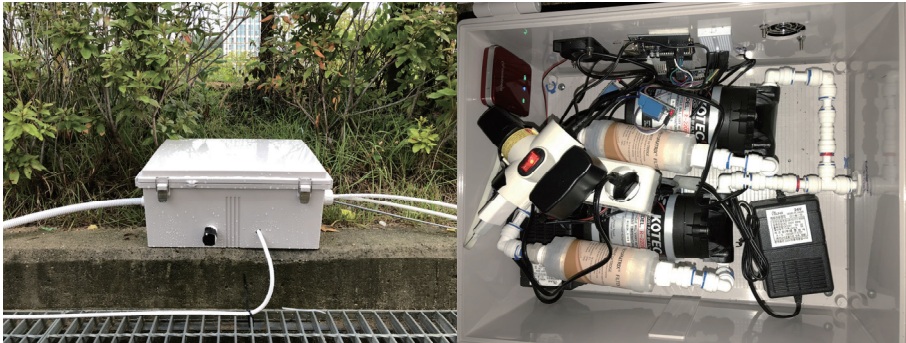
〈그림 22〉 컨트롤박스 설치 현황
