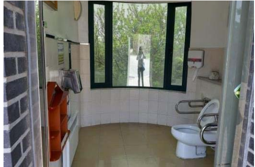
〈진달래 화장실 : 장애인 화장실 휴지걸이가 높은 곳에 설치되어 있어 이용 불편〉
