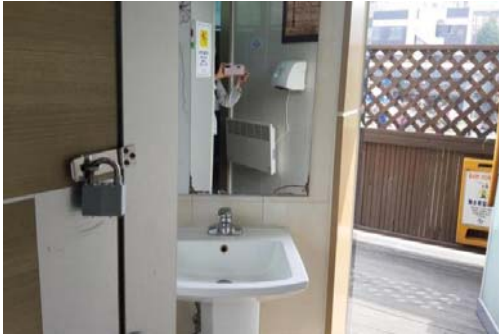
〈팔달문 화장실 : 협소한 공간, 장애인용 안전시설 부족〉
