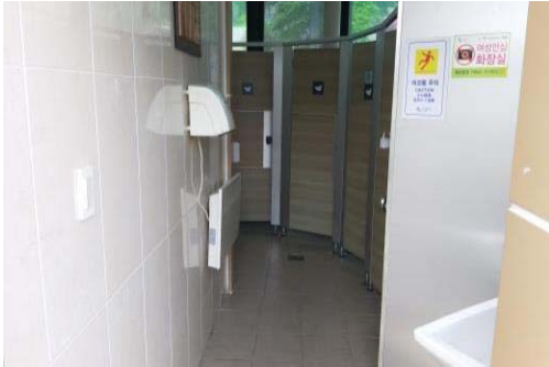
〈팔달문 화장실 : 진입로가 좁아서 휠체어 이용에 한계〉
