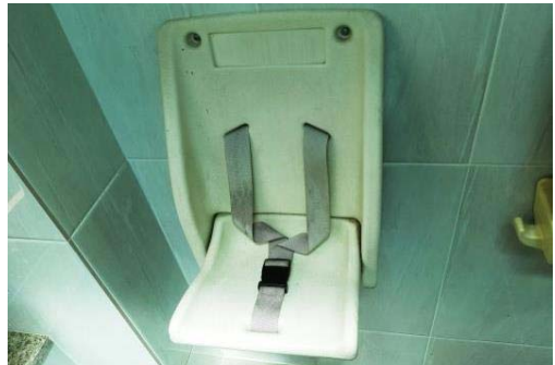
〈진달래 화장실 : 유아용 편의시설 청결상태 불량〉
