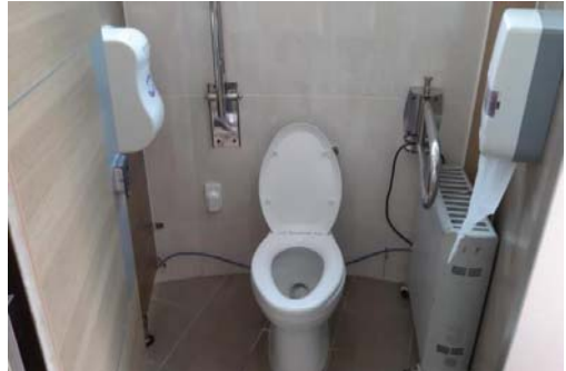
〈팔달문 화장실 : 여성화장실에만 장애인용 손잡이 설치〉
