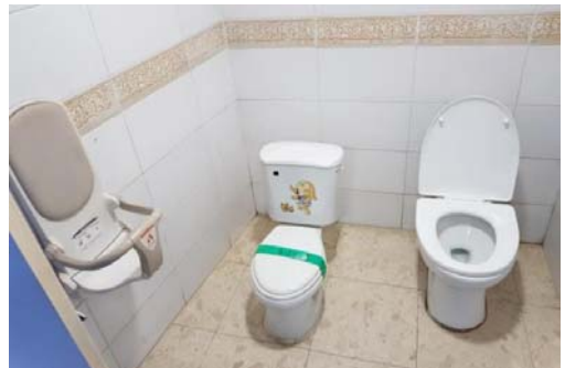
〈창룡문 외성 화장실 : 영유아용 변기 고장〉
